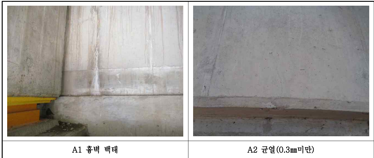
【사진 38.3.25】 교대 손상현황
