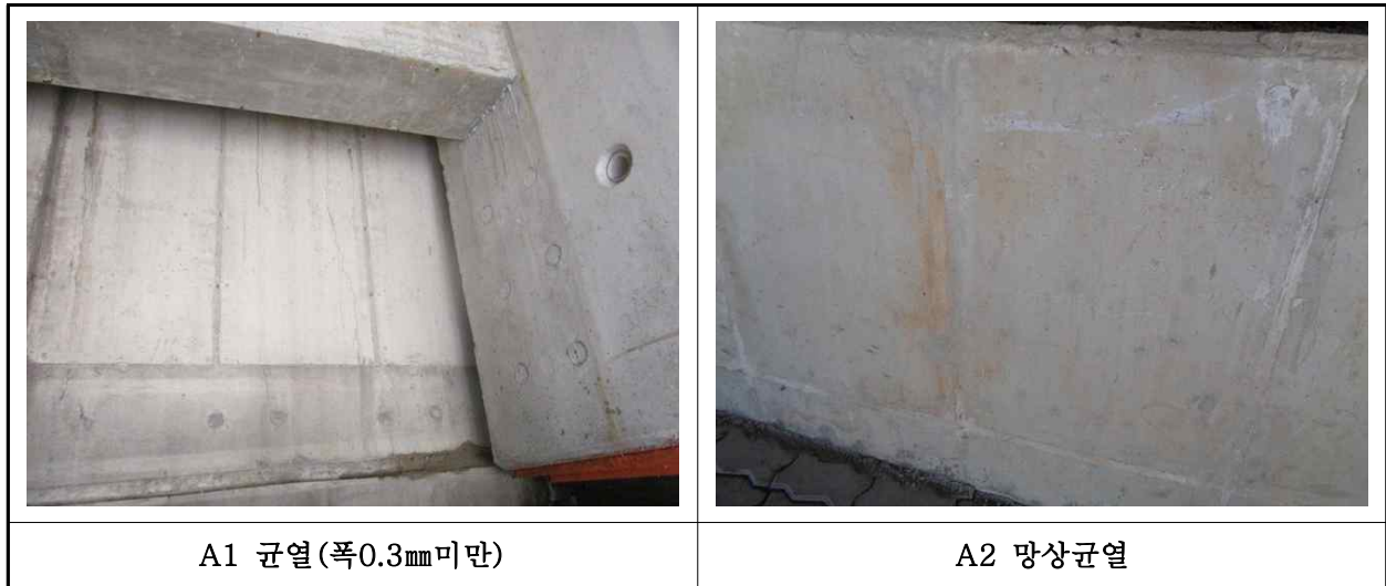
【사진 38.3.7】 교대 손상현황
