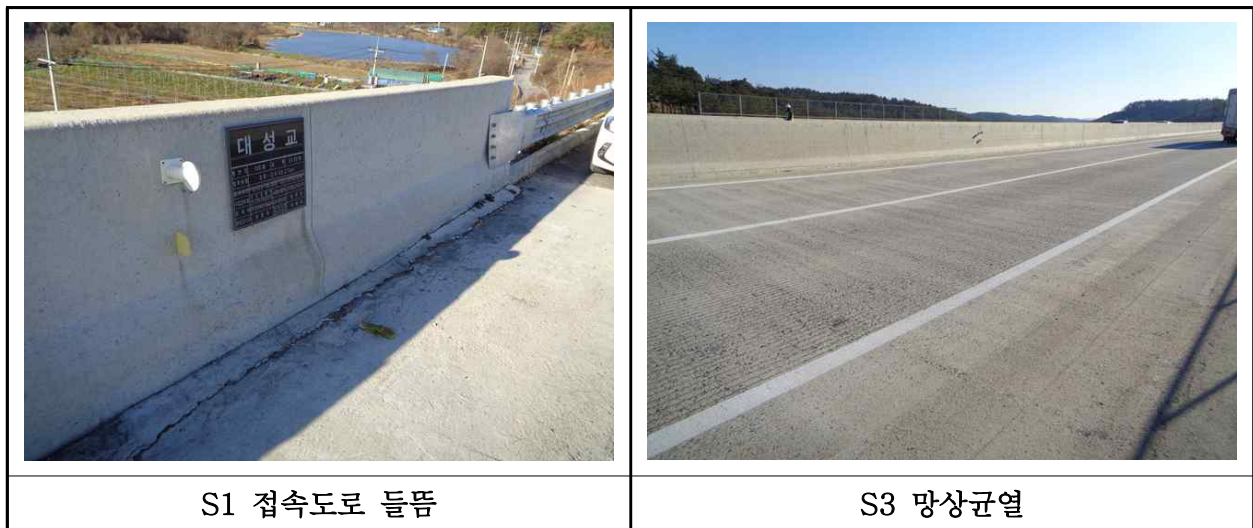
【사진 38.3.36】 교면포장 손상현황
