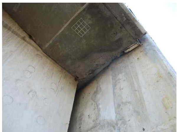
S1 바닥판하면 파손
