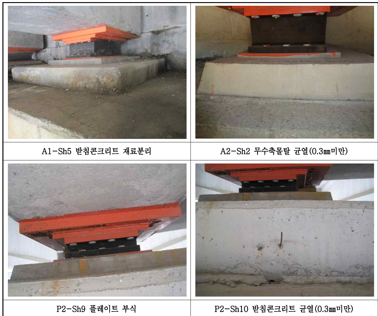
【사진 38.3.11】 교량받침 손상현황
