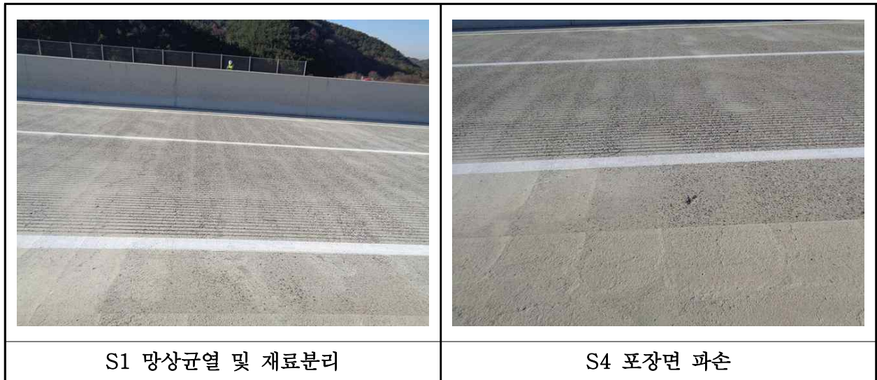
【사진 38.3.18】 교면포장 손상현황
